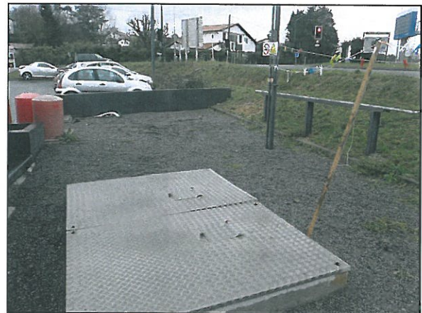
Vue sur le réservoir DE/PT de 70 m 3 GO + 10 m 3 GNR
